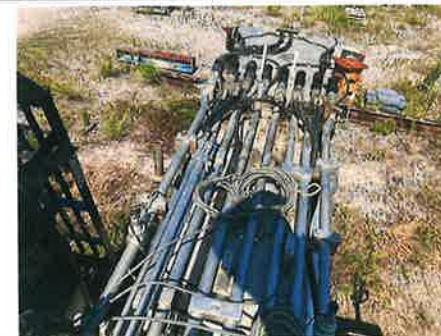
⑦ : フロント 油圧配管・ホース
