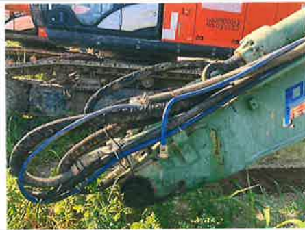
④：フロント 油圧配管・ホース
