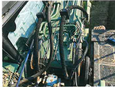
⑥：フロント 油圧配管・ホース
