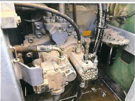
⑤：上部旋回体 ポンプ装置
