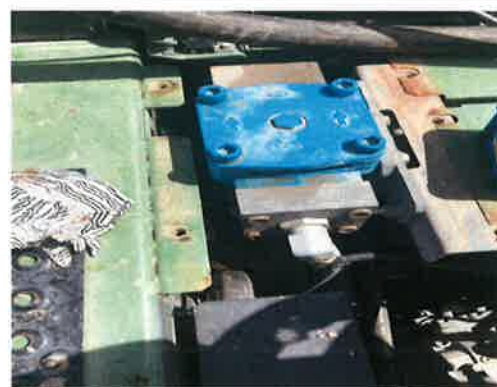
△: 上部旋回体 作動油タンク・作動油
