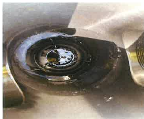
△: 上部旋回体 作動油タンク・作動油 汚損が見受けられます。
