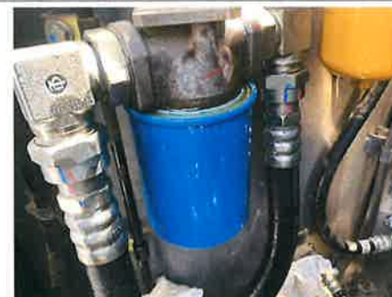
○ : 上部旋回体 作動油タンク・作動油
