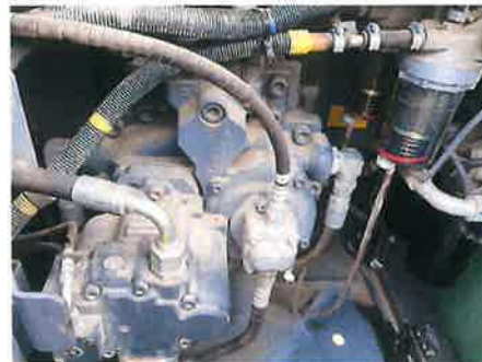
○ : 上部旋回体 ポンプ装置
