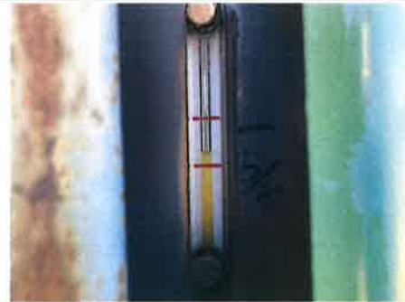
○：上部旋回体 作動油タンク・作動油
