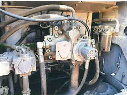
◎：上部旋回体 ポンプ装置
