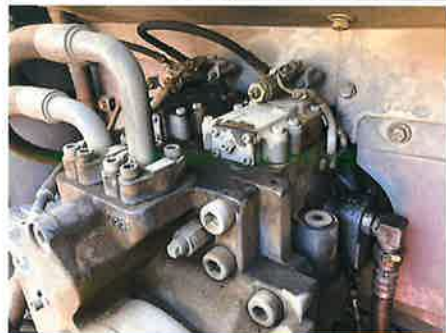
△：上部旋回体 ポンプ装置
