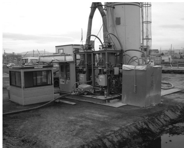
写真-1.2 改良材プラント
